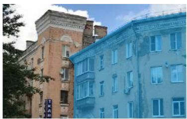
12 Фасады зданий требуют реставрации
